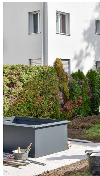
Die Hochbeete in der Siedlung Holzries wurden vom Gärtnerteam der GBL aufgestellt. Dabei mussten im Vorfeld das Gelände terrasiert und Platten verlegt werden.
