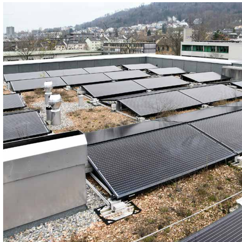
Bestehende Solaranlage in der Siedlung Wässeri.
